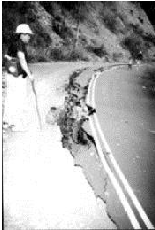
往仁愛鄉法治村的路上，道路已嚴重損毀，險象環生。
