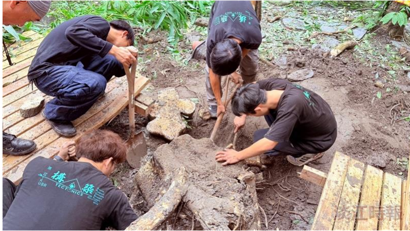
康芮颱風肆虐，宜蘭蘇澳岳明國中小校園中彩虹橋一旁的大樹被強風撲倒，砸壞了平台，現場滿目瘡痍。（圖／「淡江構築」提供）
