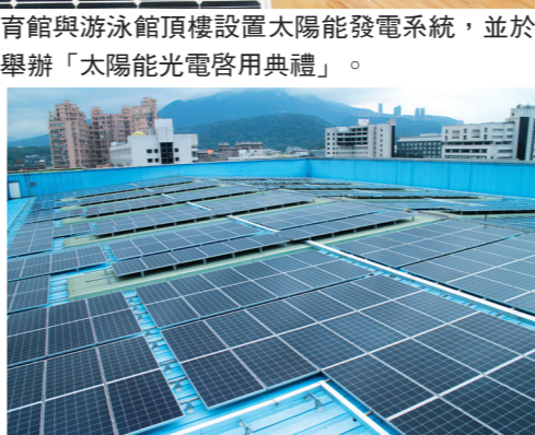
▲紹謨紀念體育館與游泳館屋頂設置太陽能發電系統，共架設1636片太陽能光電板，圖為紹謨紀念體育館屋頂之太陽能光電版。
